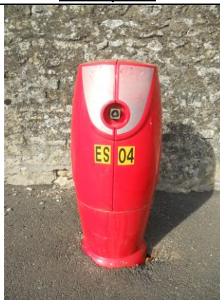
PI avec un marquage rétro-réfléchissant
